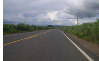
Figura 7. Insuficiência de acostamento
