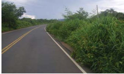
Figura 6. Falta de limpeza da faixa de domínio
