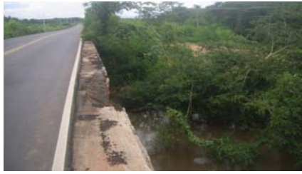
Figura 4. Ponte presente na rodovia com proteção parcial e ausência de sinalização vertical
